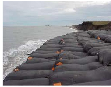
(b) Revetment using sandbags (Kaktovik, Alaska)
